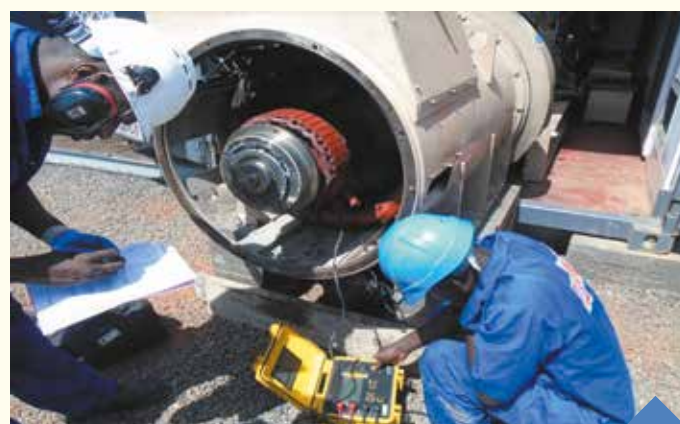
Contrôle valeur ohmique Alternateur 1400KVA CLIENT : AGGREKO Centrale Cap des Biches
