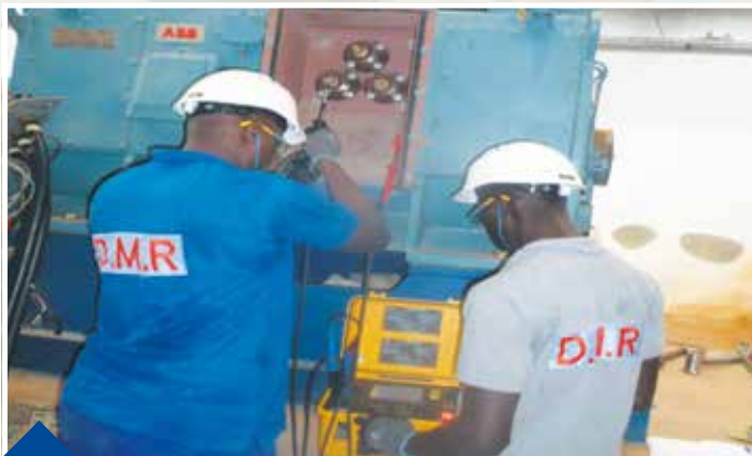
EXPERTISE ELECTRIQUE : Mesure valeurs d'isolements et résistances d'enroulements avant travaux
