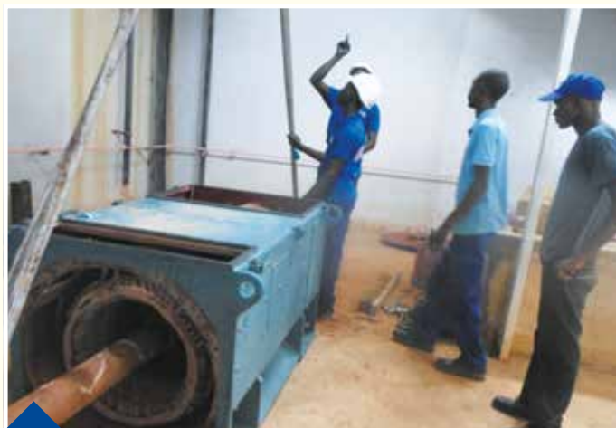
DEMONTAGE : Extraction du rotor
