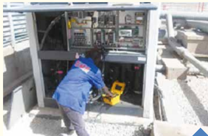
Contrôle valeur d'isolement compresseur CLIENT: IBIS HOTEL
