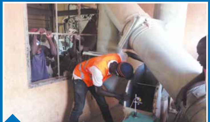
Equilibrage sur site ventilateur dépoussiérage HF196N°1 CLIENT : CMDT (Mali FANA)
